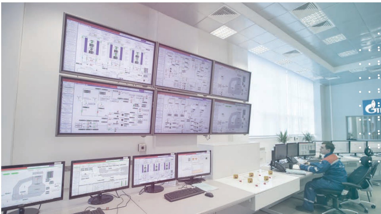
Пульт управления Центральной ТЭЦ. Наши дни
